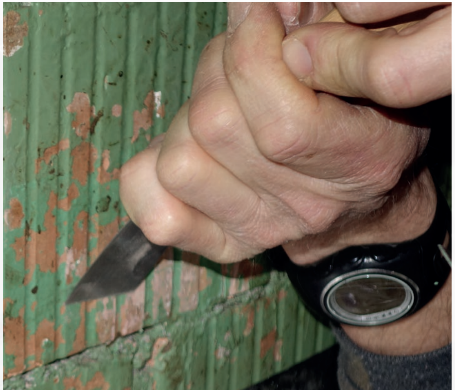
Die Stallwand wurde vor Jahrzehnten mit PCB-haltiger Farbe gestrichen. Probenahme für die Untersuchung.
