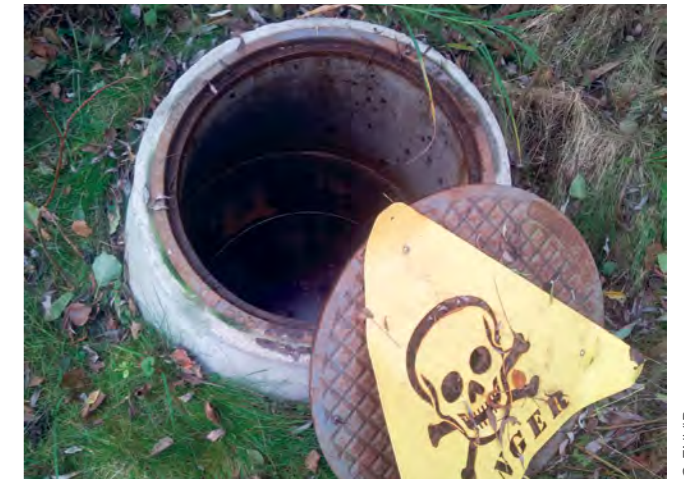
Sickerwassersammler, in dem die Proben für die Analyse im Zusammenhang mit der Hausmülldeponie entnommen wurden.
