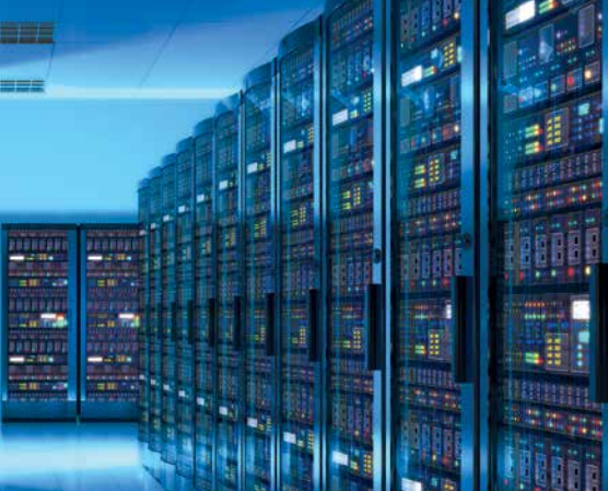
Inneres eines Serverraumes in einem Rechenzentrum.
